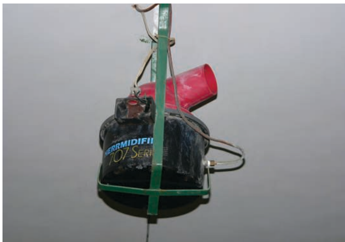
Unidad de humificación en cuarto de almacenamiento
