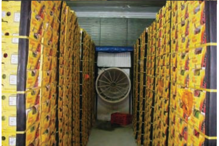
Túnel de resfriamento com ar forçado
